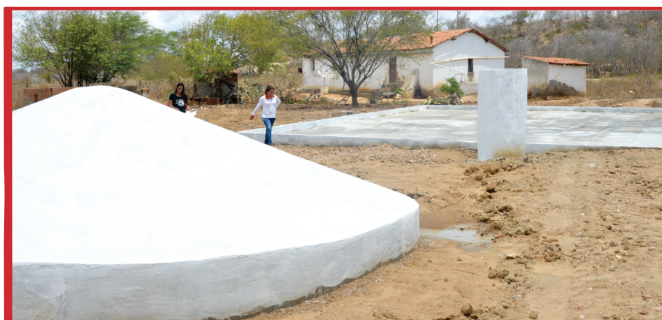
Figura 05 - Cisterna de Produção Calçadão.
